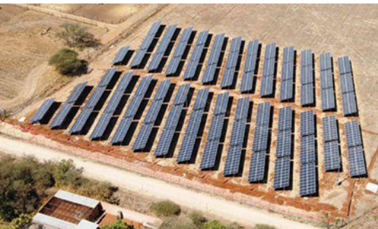
'n Lugfoto van 'n sonplaas wat EEC in Limpopo geïnstalleer het. (Foto's: Verskaf deur EEC)
